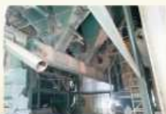
成品桶下方因作業人員作業要爬上翻料故應加裝護欄及平台
