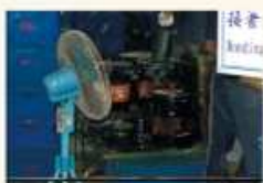
接著區(有機溶劑)應使用防爆電扇
